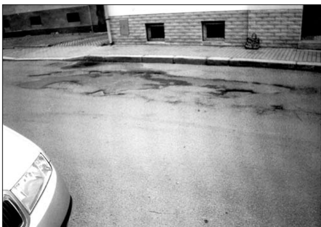
Opravený asfalt s dírami na eliptické geopatogenní zóně dlouhé 6 m a široké 1,5 m ve směru západ - východ. Byla zjištěna intenzita geopatogenní zóny na zemském povrchu 40° a ve výšce 50 m 90°. Zvodnění v hloubce 10 m nebylo zjištěno, v hloubce 20 m vlhké horniny a v hloubce 30 m malé zvodnění. V podélné ose byla nalezena lineární geopatogenní zóna široká 0,2 m s intenzitou 20° a do hloubky 30 m pouze vlhké horniny na zóně. Přesně na dírách v asfaltu byla nalezena křížení pásů obou globálních mříží. Lipová ulice v České Lípě, pohled k JJV.
