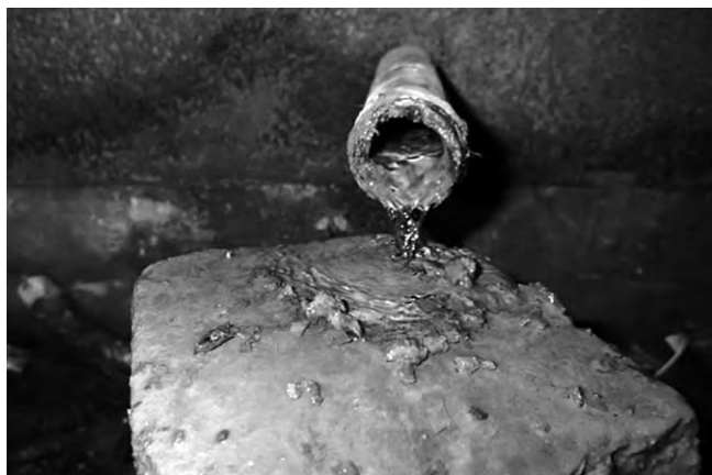
Jenom ventil od přívodního potrubí si někdo vypůjčil. Tím po řadu roků vytékající voda podmáčela školu.
